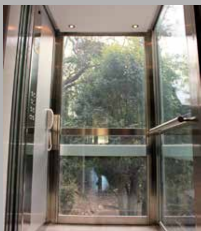
porte di cabina a soffietto
